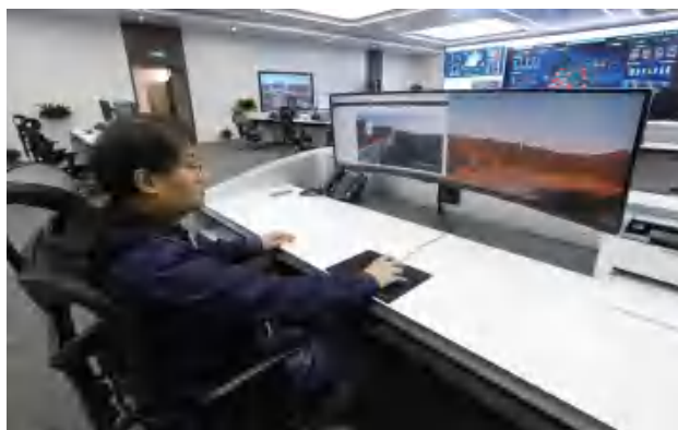
10月22日，密云供电公司反外力监控中心工作人员通过视频监控系统查看输电线路通道运行情况
